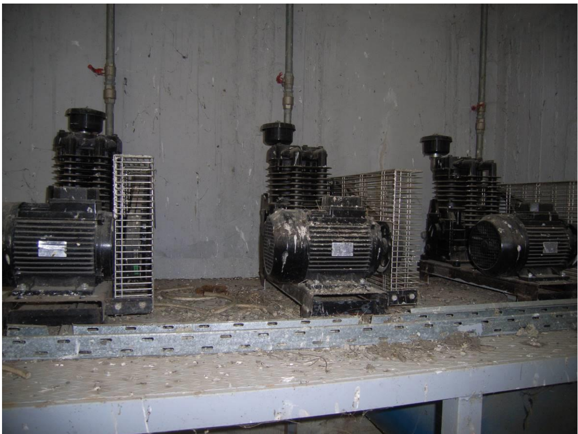
Φώτο 16 : Αεροσυμπιεστές Ζωνών No 1 & No 2
