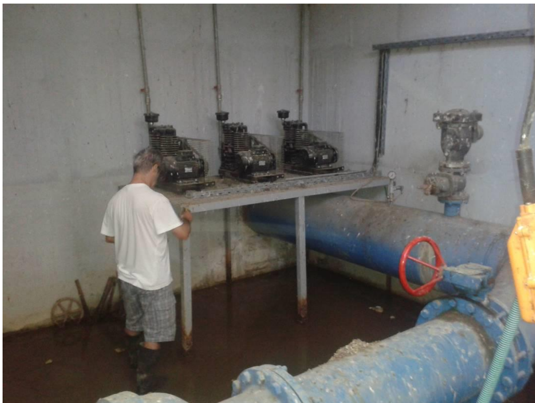
Φώτο 27 : Συγκέντρωση νερού λόγω διαρροών στον υπόγειο χώρο αντλητικών συγκροτημάτων αντλιοστασίου αρδευτικών Ζωνών 1, 2, 3 & 4
