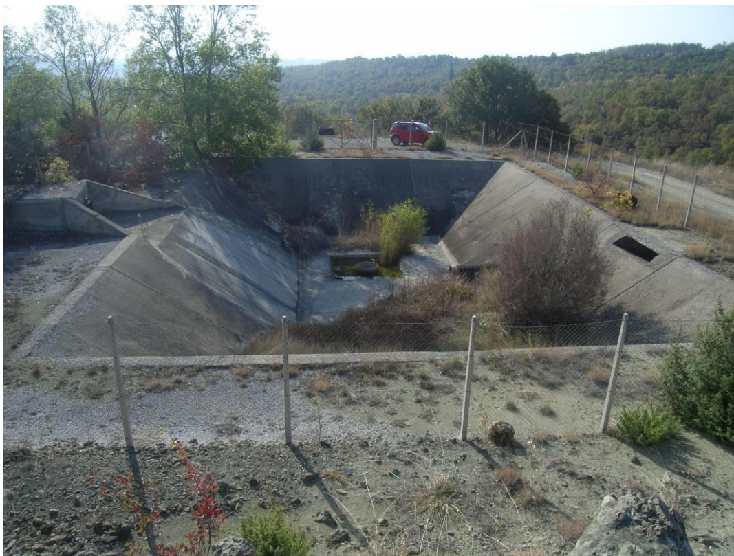
Φώτο 3 : Δεξαμενή ηρεμίας απόληξης κεντρικού καταθλιπτικού αγωγού κεντρικού παρόχθιου αντλιοστασίου (+503,44m)
