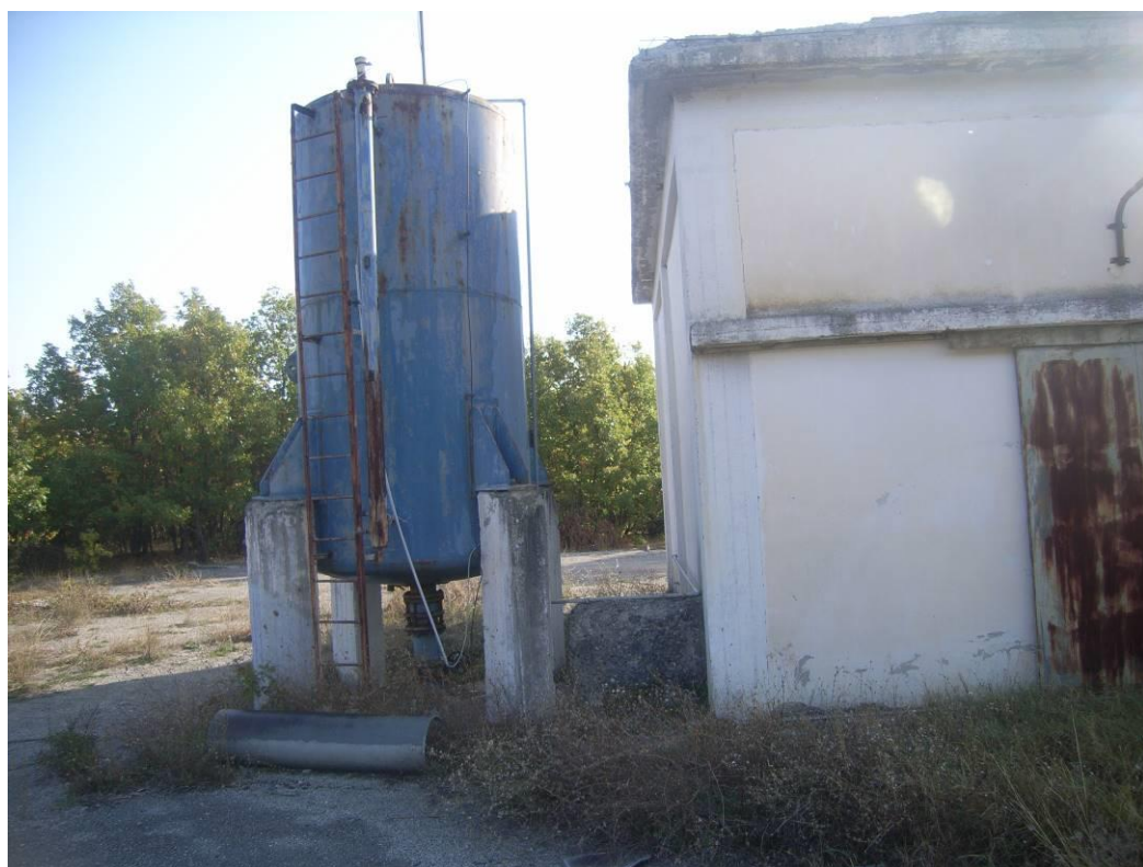
Φώτο 28 : Υφιστάμενο αεροφυλάκιο αντλιοστασίου Ζώνης Νο 5 εκτός λειτουργίας
