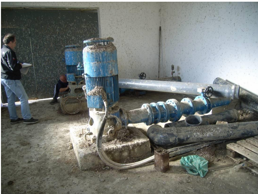
Φώτο 29 : Εσωτερικό αντλιοστασίου Ζώνης Νο 5 – χώρος κινητήρων αντλιών
