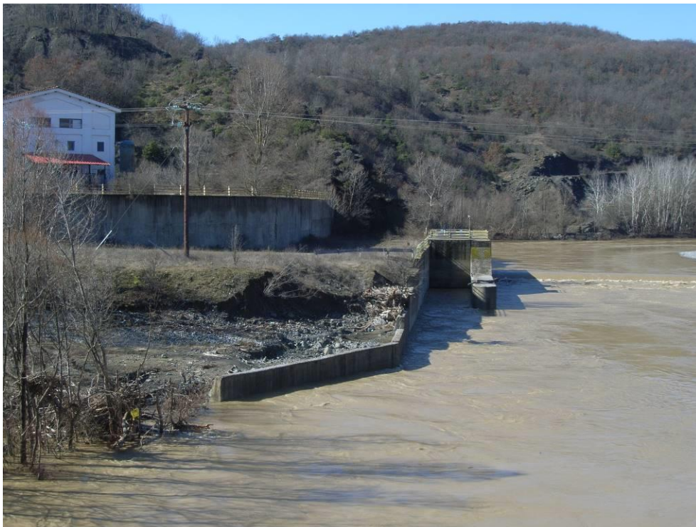
Φώτο 1 : Κεντρικό παρόχθιο αντλιοστάσιο και έργα υδροληψίας στον ποταμό Αλιάκμονα
