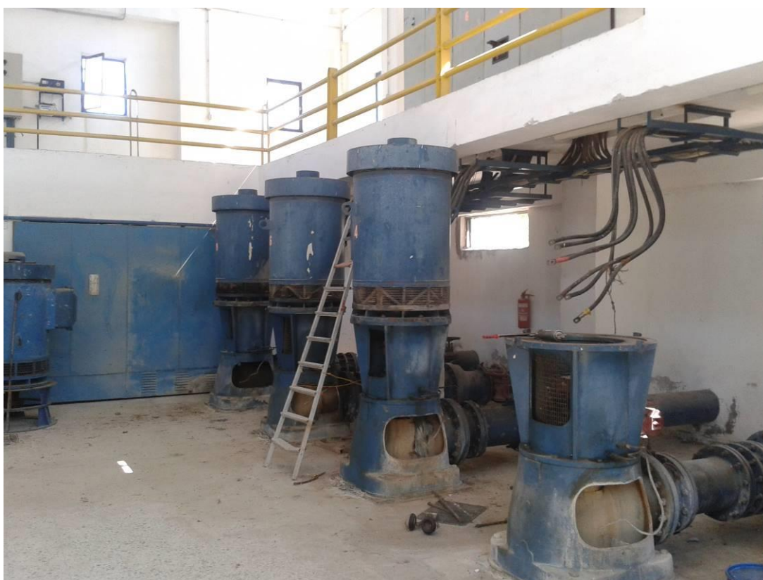
Φώτο 10 : Κεντρικό αντλιοστάσιο υδροληψίας - Αποσυναρμολογημένος κινητήρας αντλητικού συγκροτήματος P_R-001
