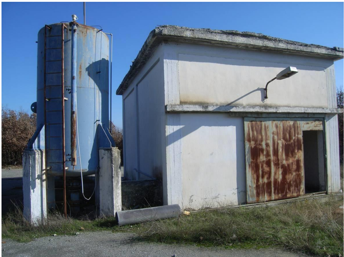
Φώτο 8 : Υφιστάμενο αντλιοστάσιο αρδευτικής Ζώνης Νο 5 (+556,4m)
