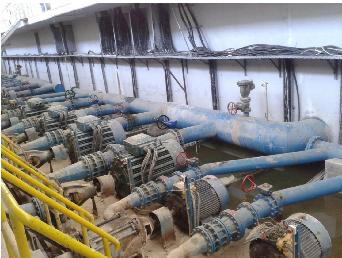
Φώτο 5 : Κεντρικό αντλιοστάσιο άρδευσης – αντλητικά συγκροτήματα Ζωνών No 1 & No 2
