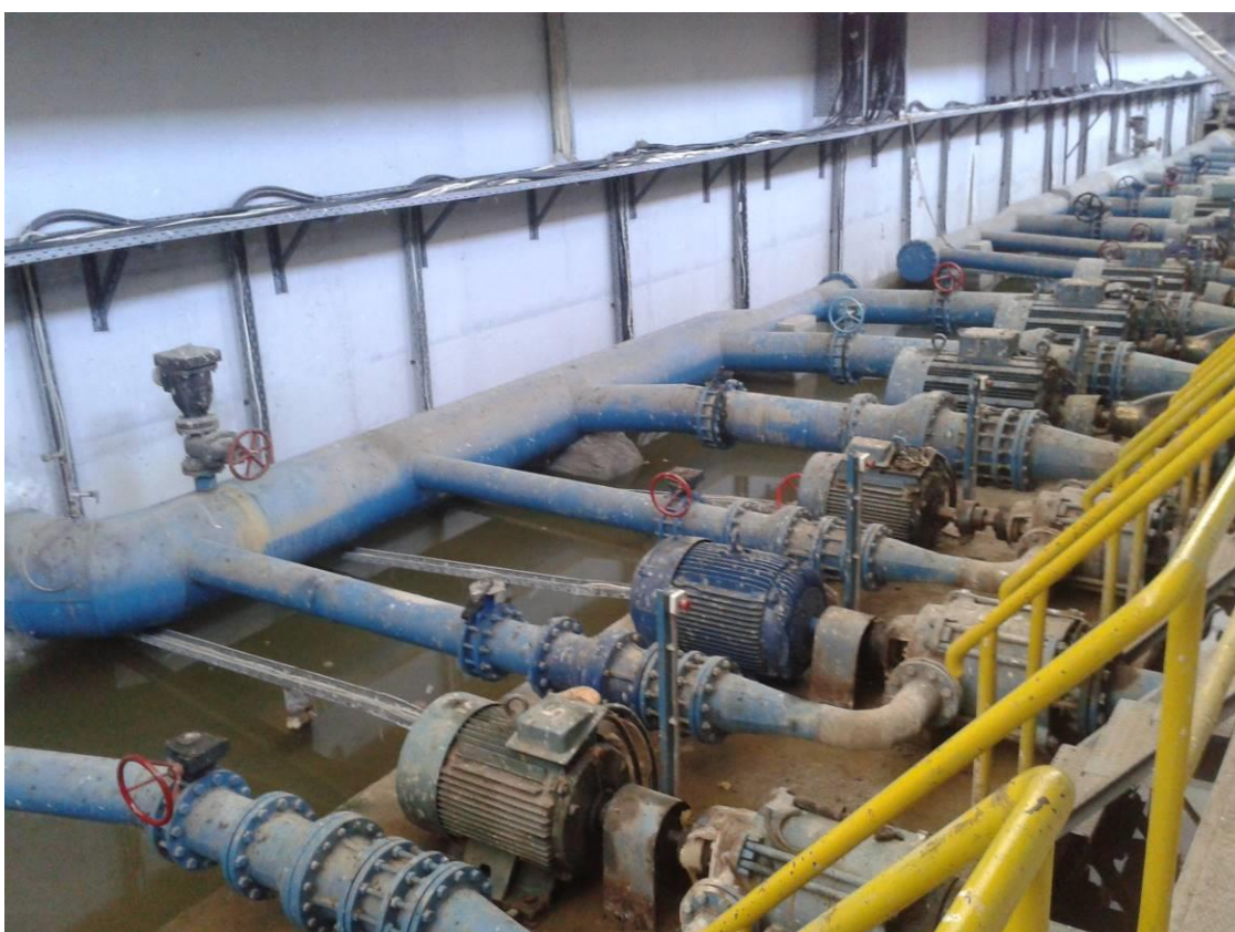
Φώτο 6 : Κεντρικό αντλιοστάσιο άρδευσης – αντλητικά συγκροτήματα Ζωνών No 3 & No 4
