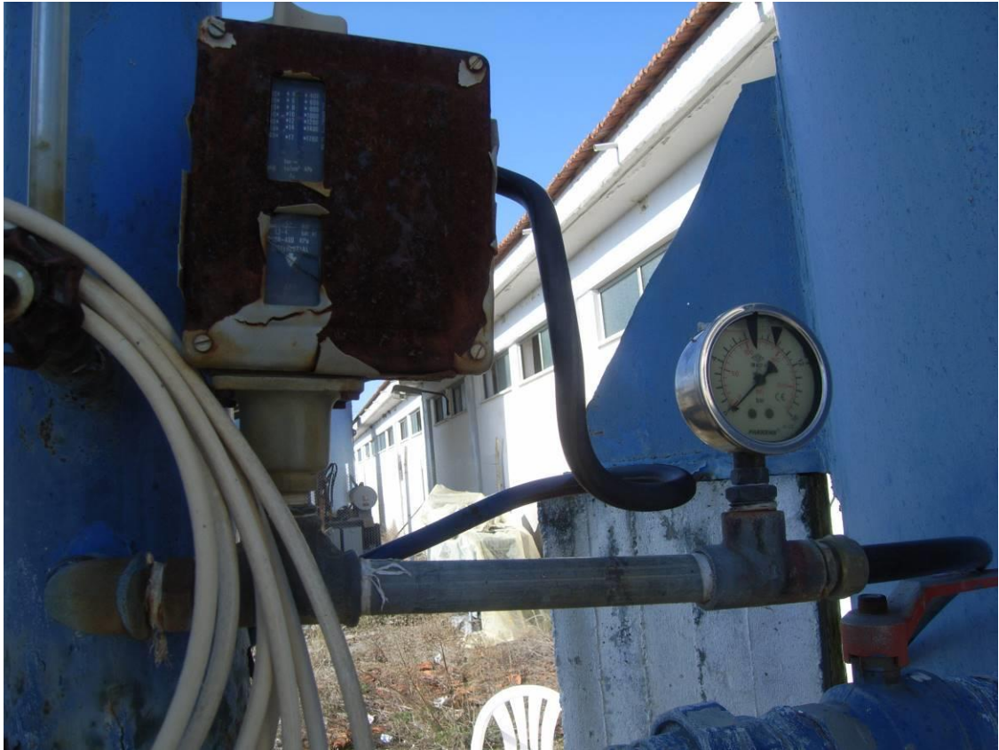
Φώτο 15 : Πιεζοστάτης αεροφυλακίου Ζώνης No 2
